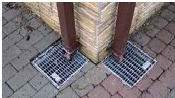
г. Казань, двор офиса, универсальные дождеприемники
