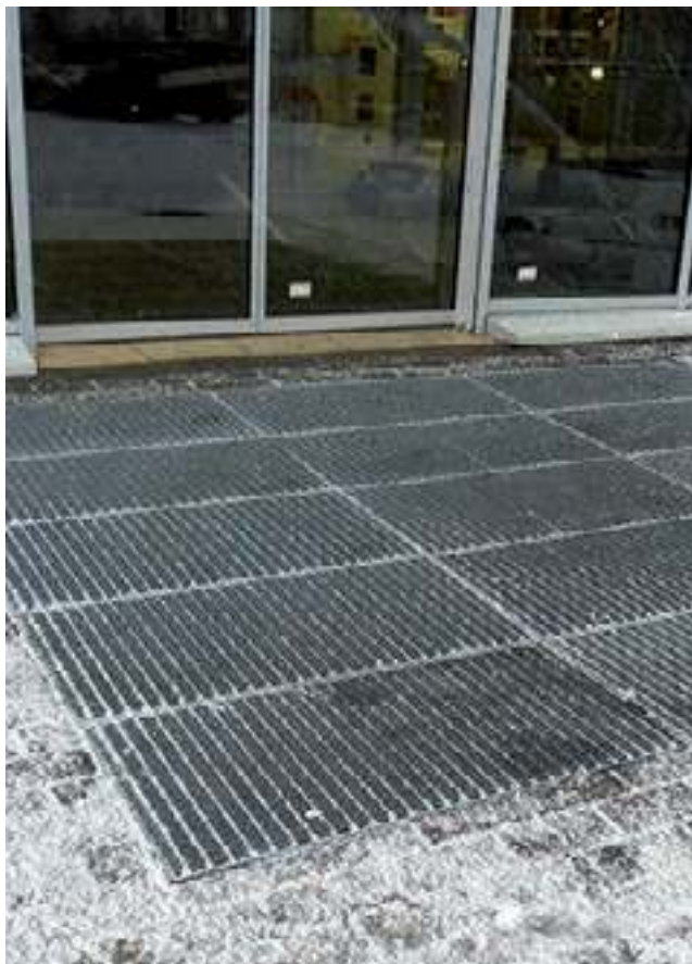
г. Тосно, супермаркет «Лента», придверное грязезащитное покрытие
