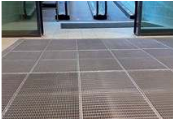
г. Новосибирск, торговый центр, придверное грязезащитное покрытие
