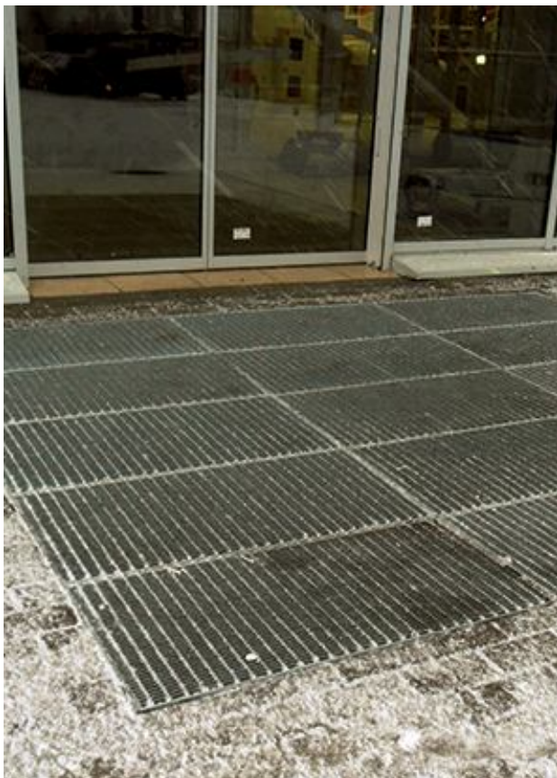
г. Тосно, супермаркет «Лента», придверное грязезащитное покрытие
